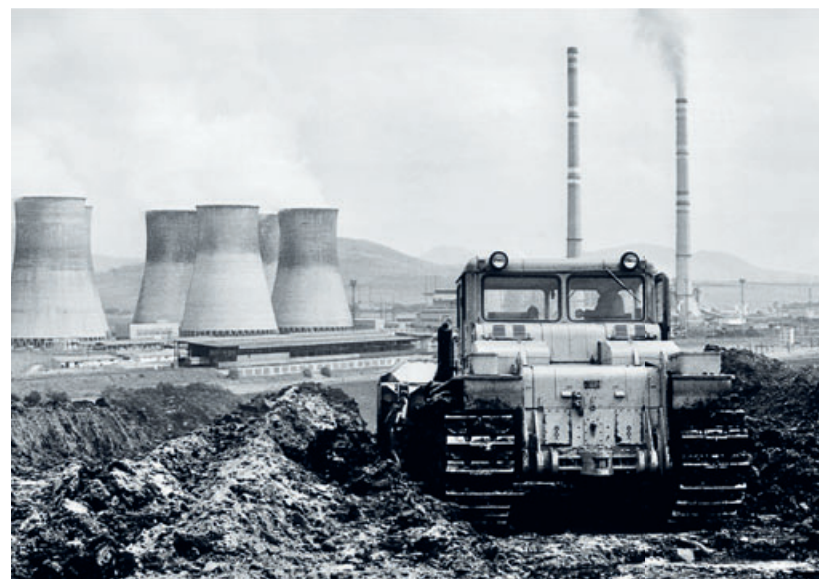
Úprava svahů vnější výsypky lomu Třískolupy v blízkosti počeradské elektrárny, pro kterou bylo původně určeno uhlí z tohoto lomu. Foto z r. 1978.
