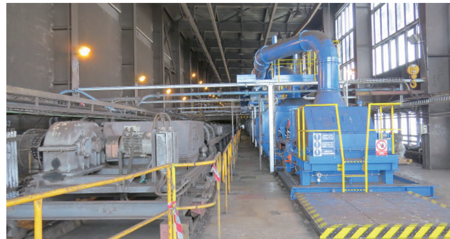
Rekonstruované zařízení zauhlovací linky v elektrárně Chvaletice. Foto: (kapr)
