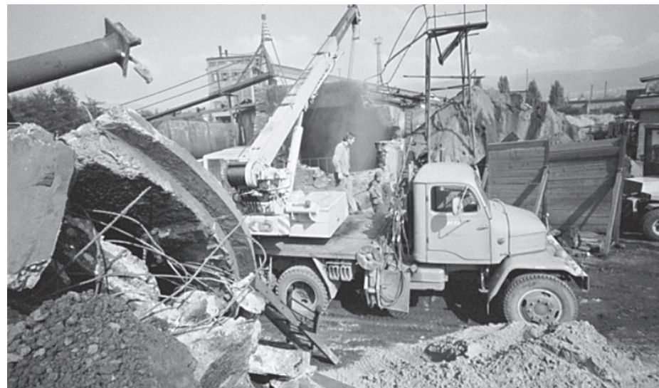
Havárie na Dole Pluto napáchala obrovské škody v hlubině i na povrchu. Foto: Archiv DN
