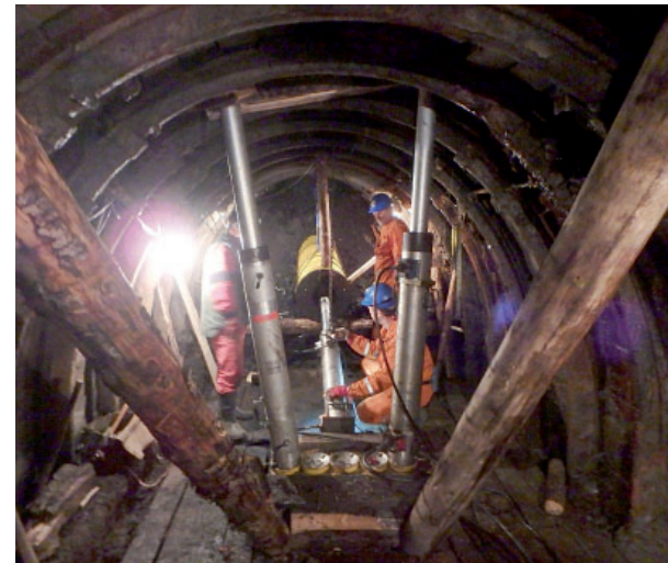
Stávající způsob použití vyprošťovacího potrubí. Foto: Archiv HBZS
