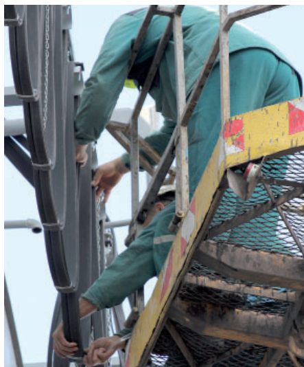
Na některá místa se dá dostat jen pomocí plošiny. Zaměstnanci KSK-SUB z ní opravovali kabelovou lávku napájení jeřábků pojízdného závaží. Foto: (pim)
