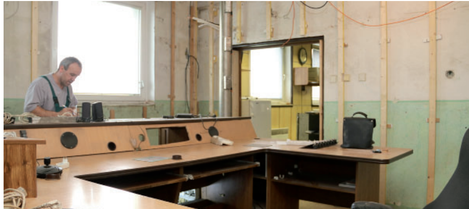
Takto vypadal dispečink na Vršanech na začátku modernizace. Foto: (pim)
