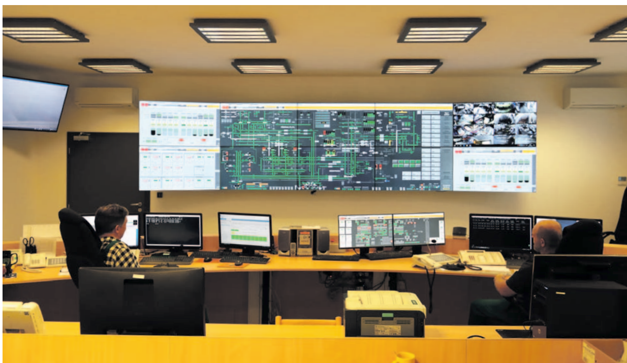
Přesunem technologického dispečinku do nových prostor skončil projekt modernizace řídicího systému úpravy uhlí. Foto: (pim)
