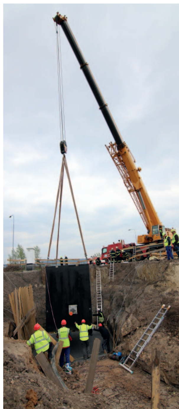
Nejsložitější částí prací bylo usazení zhruba dvaadvacetitunové armaturní šachty do místa stávajícího potrubí etylbenzenu. Foto: (pim)
